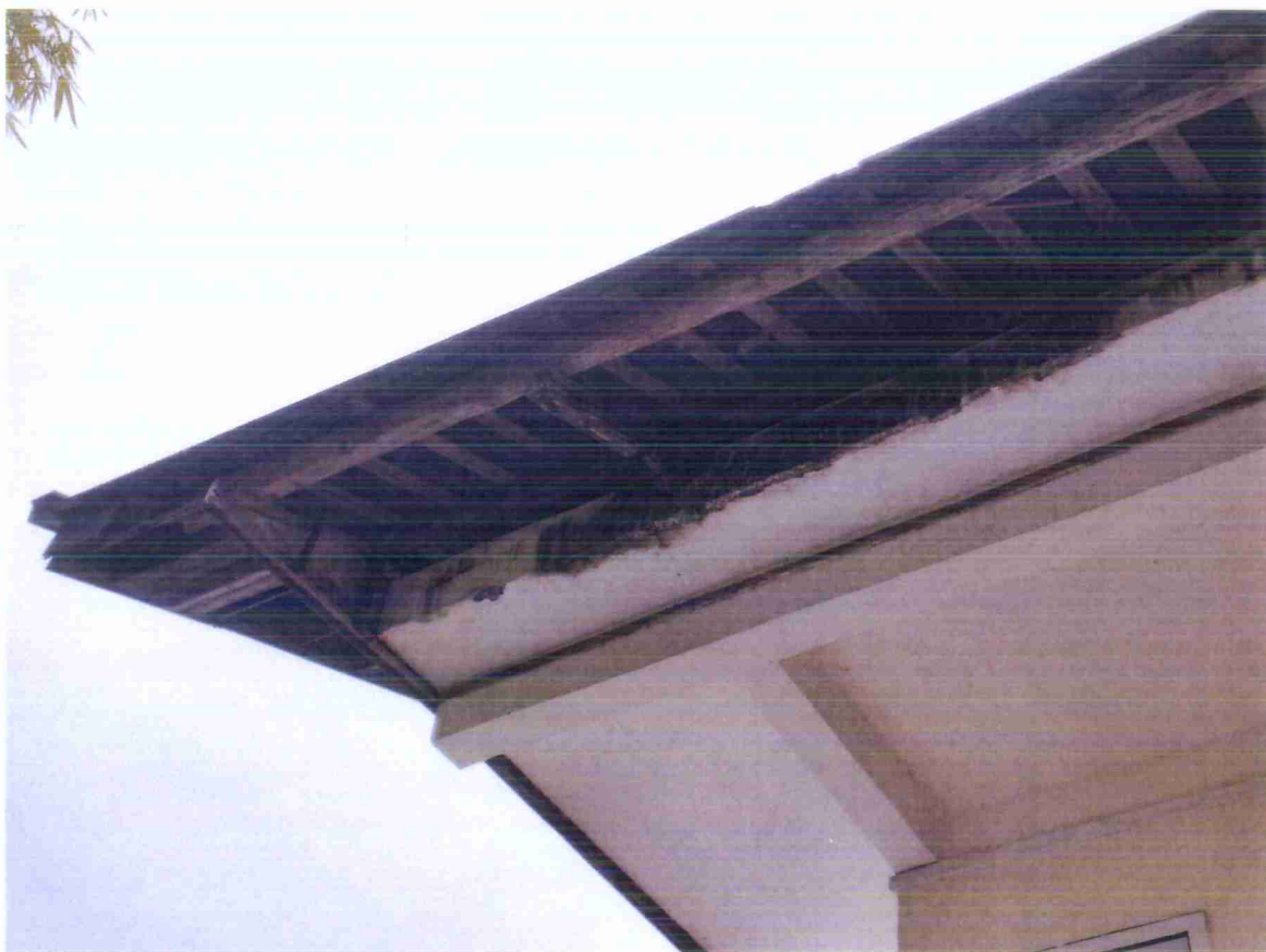
4~5×B 轴木构件腐朽
