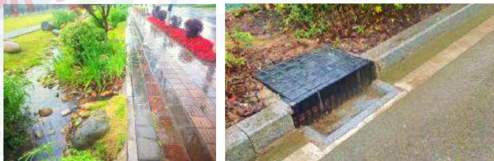
引水石+侧篦沉泥井+排水暗沟现场实拍（建平大道海绵化改造）
